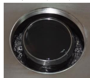
Поверхность теплоносителя (перелив)
